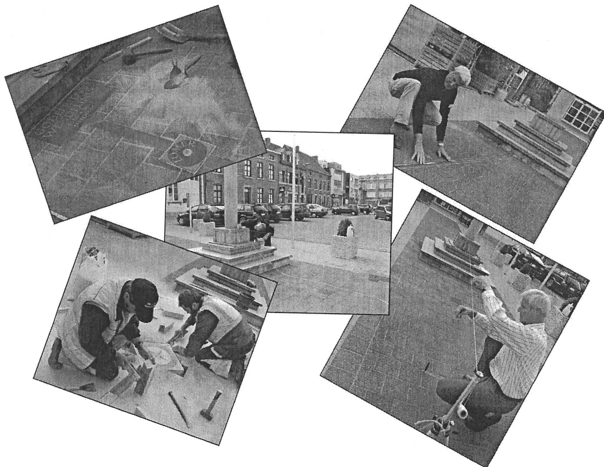
Foto 2: enkele sfeerbeelden van de aanleg van de middaglijn en het meten van de helling van het marktplein. Het bepalen van deze helling langs de te bouwen middaglijn gebeurt hier nog op een 'primitieve' manier. Een dikke proficiat aan de gemeentearbeiders die voor de uitvoering zorgden.
